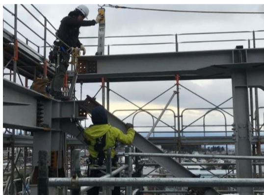
【体育館棟】大型クレーンで慎重に合図をして鉄骨を組立てていきます。
